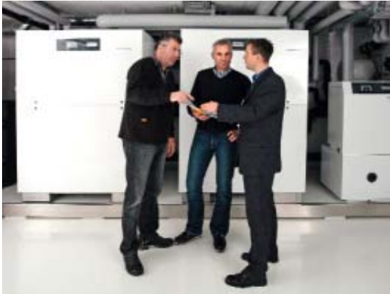
Pionierprojekt Warnemünde: Drei Sole/Wasser-Wärmepumpen entziehen dem Ostseewasser die Wärme.
